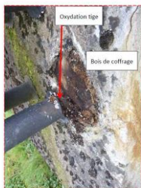
Photo 52 : Massif d'ancrage rive gauche amont – début d'oxydation de la tige
