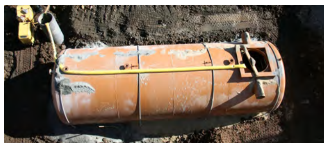
récupérateur d'eaux de pluie d'une capacité de 50 000 litres
